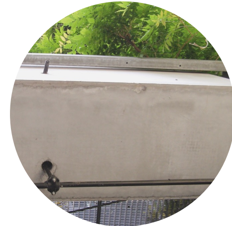
Bewässerungssystem , Blick von unten: Zulauf Anstaubewässerung und Überlauf an den Pflanzenkübeln
